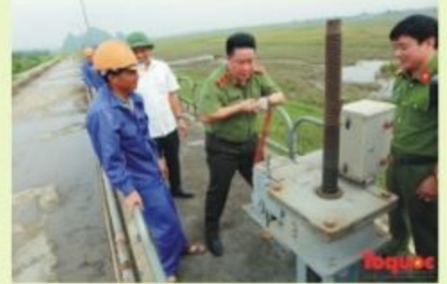
Tại trạm vận hành tràn Lạc Khoái, cống Mai Phương-Địch Lộng huyện Gia Viễn, Thứ trưởng Bùi Văn Thành tự tay kiểm tra vận hành của hệ thống xả nước lũ tại đập tràn
